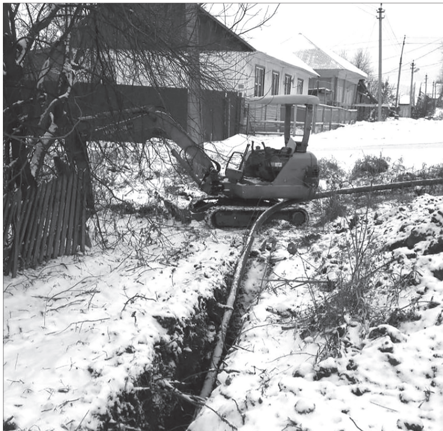
В 2021 году планируется завершить газификацию с.Уинское. В 2019 году распределительные сети газопровода прокладывались на улицах Космонавтов, Калинина, Мира, Дружбы, Набережная. Было построено 3,3 км сетей.
